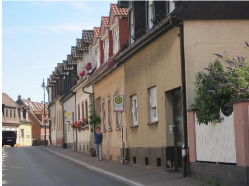
Ortsbildprägende Gebäude in schlechten baulichen Zustand (Bsp. Überführungsstr.)
