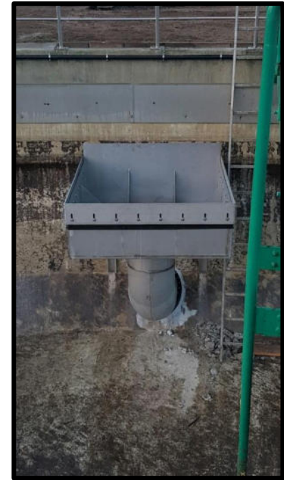
Verteilerschacht am Denitrifikationsbecken
