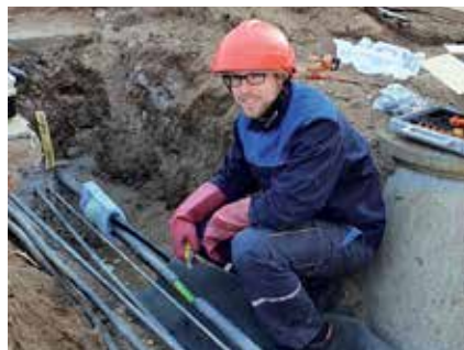
Monteur Stefan Keller schließt mit einer Hausanschlussmuffe ein sich im Bau befindliches Gebäude an das Strom-Versorgungsnetz an.
