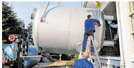
In Millimeterarbeit wird der neue Filterkessel ins Wasserwerk gehoben. Dafür musste zunächst ein Stück der Außenwand entfernt werden. ARCHIVBILD: LENHART
